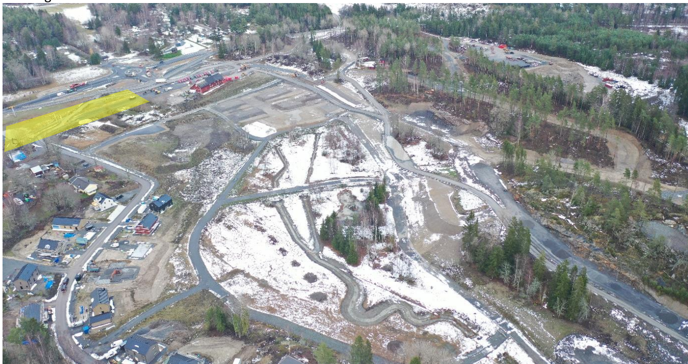
Flygbild över norra delen av Källberga, aktuell i december 2022. I norr ans Muskövägen och cirkulationsplatsen. Anläggandet av vägar och övrig allmän plats är långt kommen. Byggandet av villor har påbörjats. Planområdet är markerat med gul ton i bildens övre, vänstra del.
