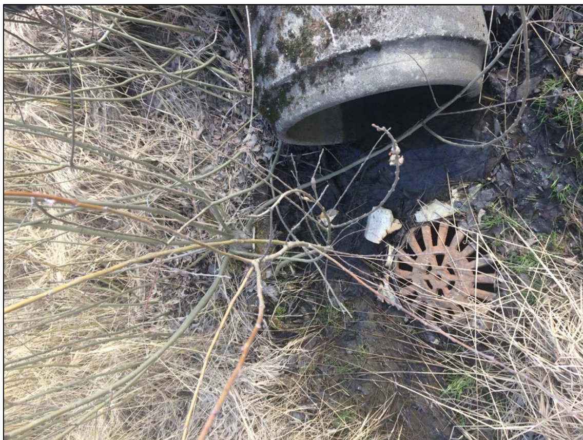
Figur 7:9. Exempel på för lågt placerad kupolbrunn vid Teknikervägens södra del.
